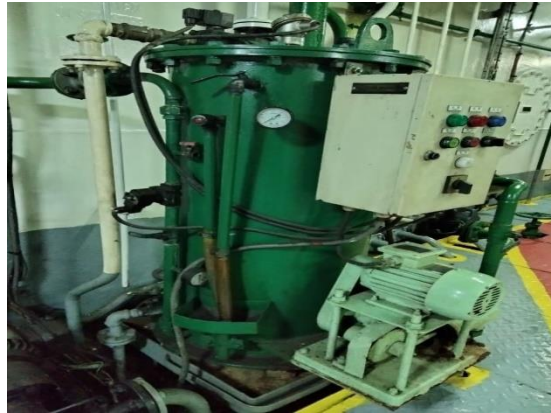
Gambar 2.2 Bilge Separator Sumber : Dokumentasi Kapal
