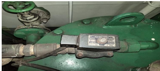
Gambar 2.3 Solenoid Valve Sumber : Dokumentasi Kapal
